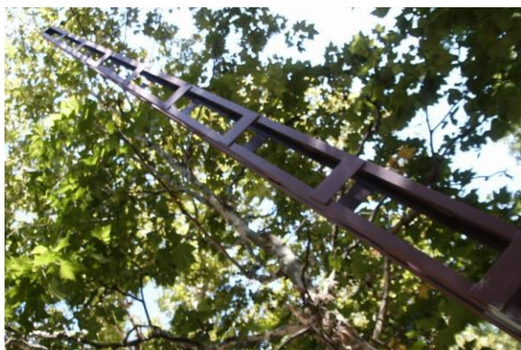
Kossuth Lajos utca, a közvilágítás tartóeleme.
