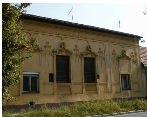
Bajcsy-Zsilinszky u. 7. – Móra Ferenc u. A Tarjányi Dezső-ház Móra Ferenc utcai, második épületének homlokzatát elcsúfító, megdőbbsítő ablakcsere.
