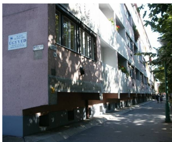
A Kossuth Lajos u. 13. brutális és balesetveszélyes homlokzata.
